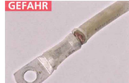
Hervortreten des blanken Leiterseils an gebrochener Seileinführung
